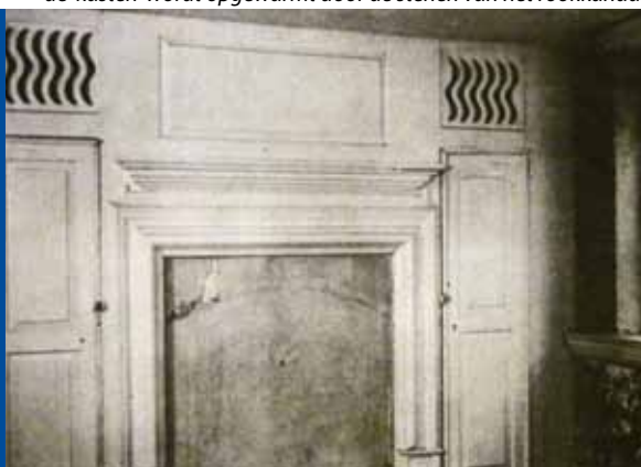
Warmteluchtkanalen naast de (dichtgemaakte) haard; lucht in de 'kasten' wordt opgewarmd door de stenen van het rookkanaal
